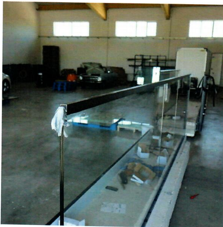
Abbildung V 02-12 Scheibe 1 durch eine identische ersetzt. Kantenschutzprofil 30x20x30 mm, t=2 mm aufgesteckt
